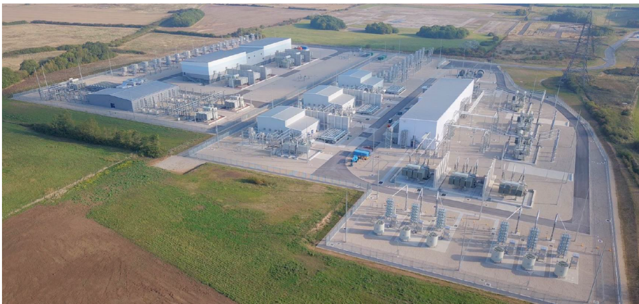
Figur 22. Exempel på två av Ørsted's transformatorstationer. På bilden syns transformatorstationerna Hornsea 1 och 2 som tillsammans omfattar ca 80 000 m 2 .
