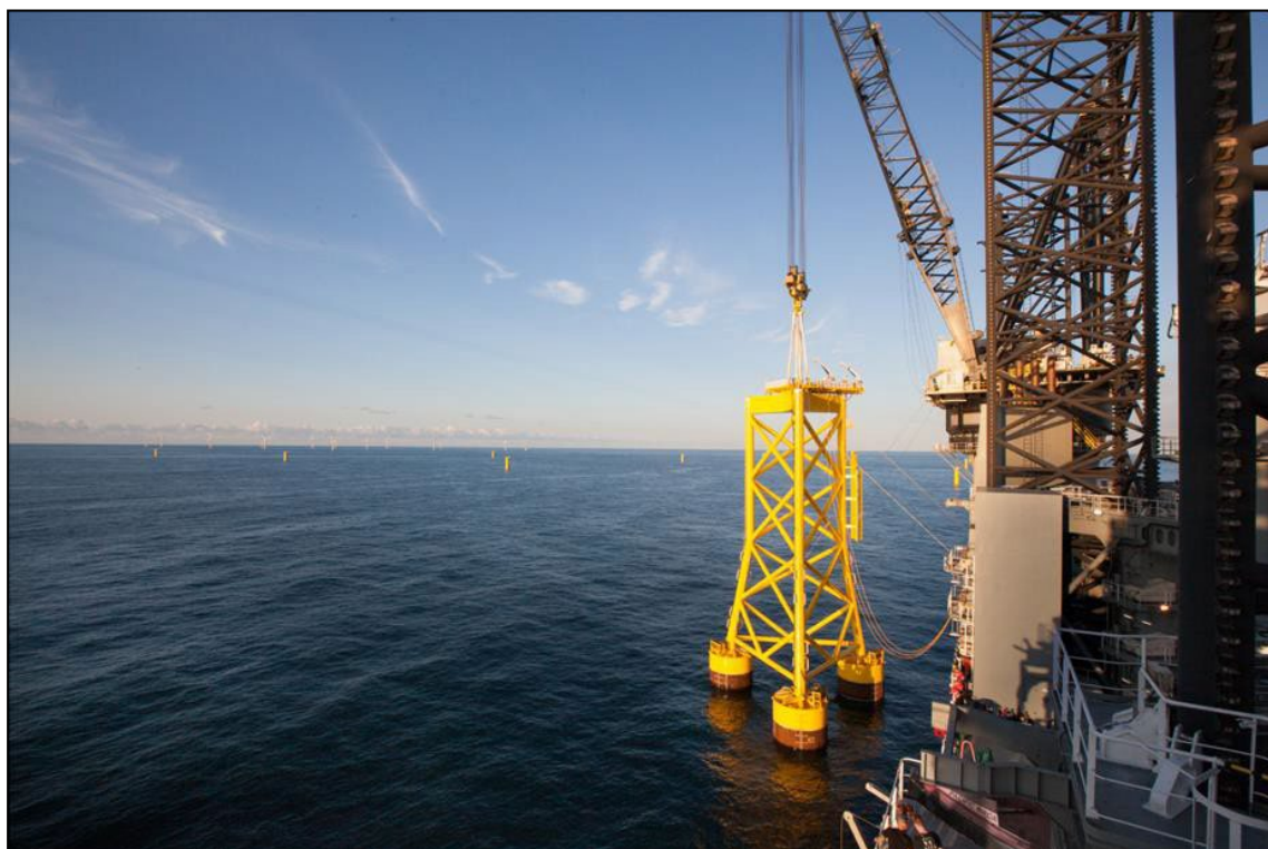
Figur 4-6 Sugkassunfundament (Bild: Borkum Riffgund).
