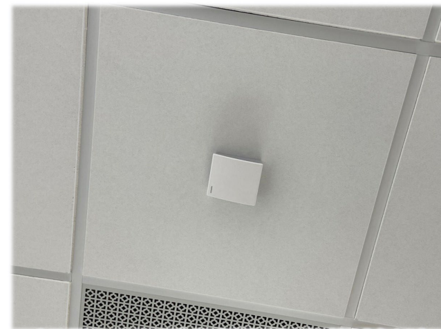
設置IAQ監測器並定期檢測
