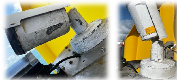
圖1.6-4 監測設備鏽蝕情況
