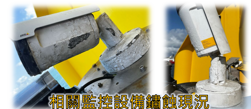
撞擊偵測系統及熱影像儀安裝情況
