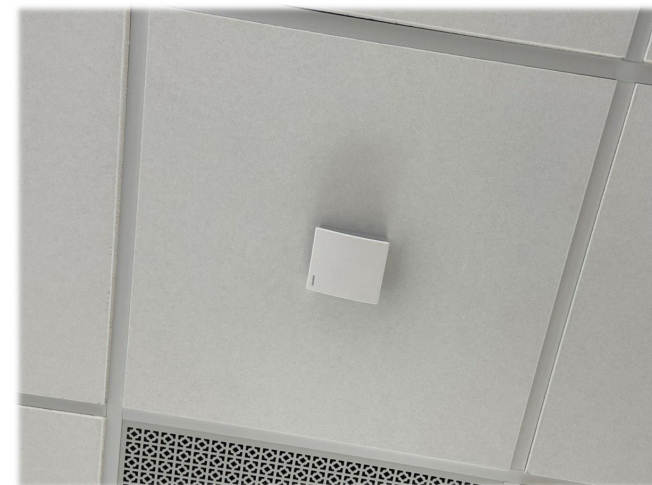
設置IAQ監測器並定期檢測
